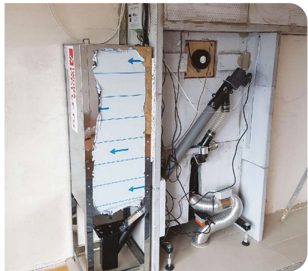
Exemple de réalisation avec le réservoir dans la pièce derrière la cheminée
