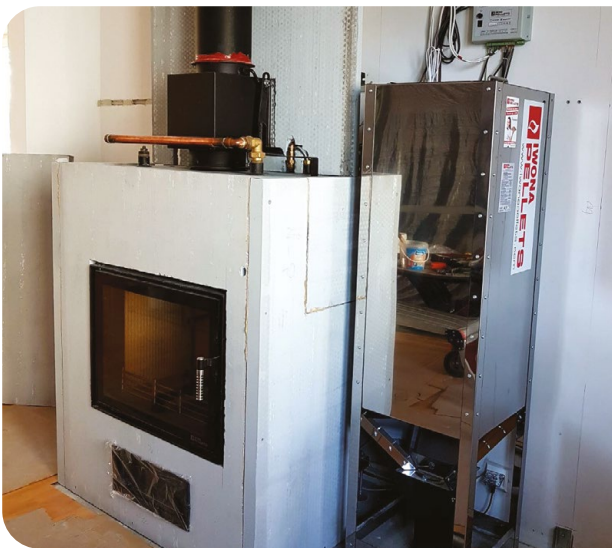
Exemple de réalisation avec le réservoir à côté de la cheminée
